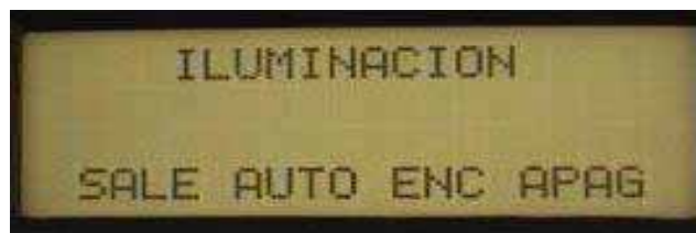
Fig.12 Pantalla de control de Iluminación
